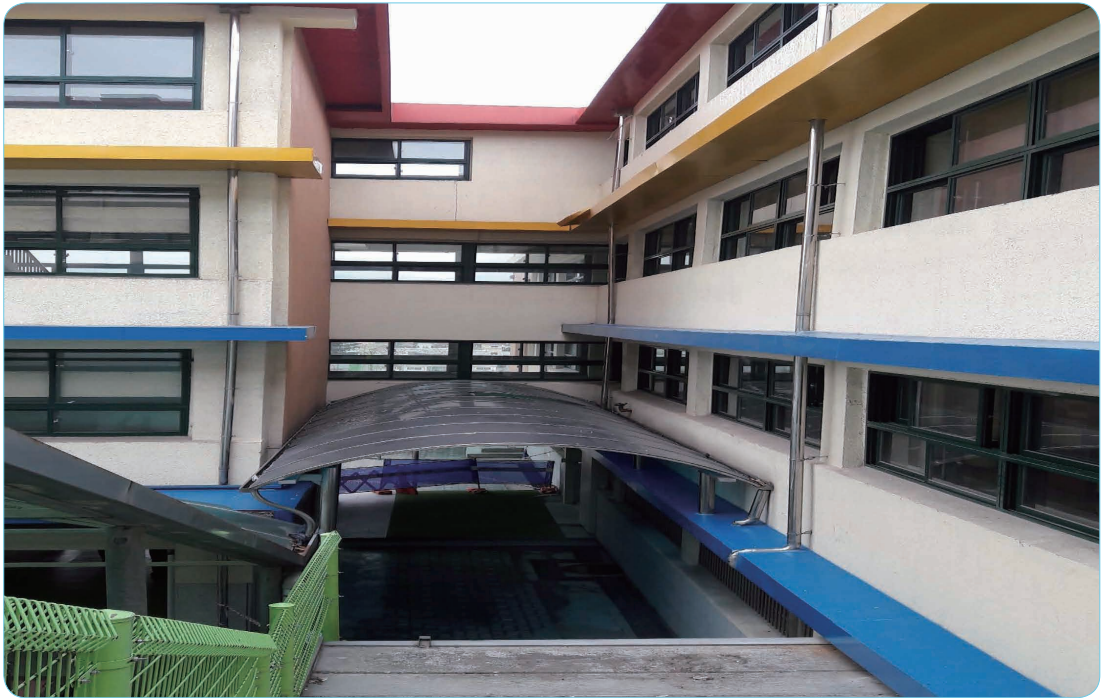
[사진1] 재해발생 현장 전경(하부 구조물 등으로 인해 고소작업대 사용이 불가능한 상황이었음)
