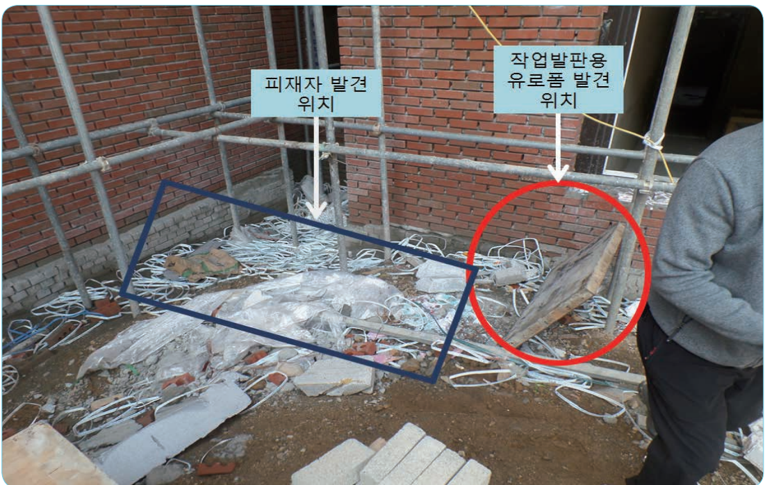
[사진2] 재해자와 작업발판용 유로폼 발견 위치
