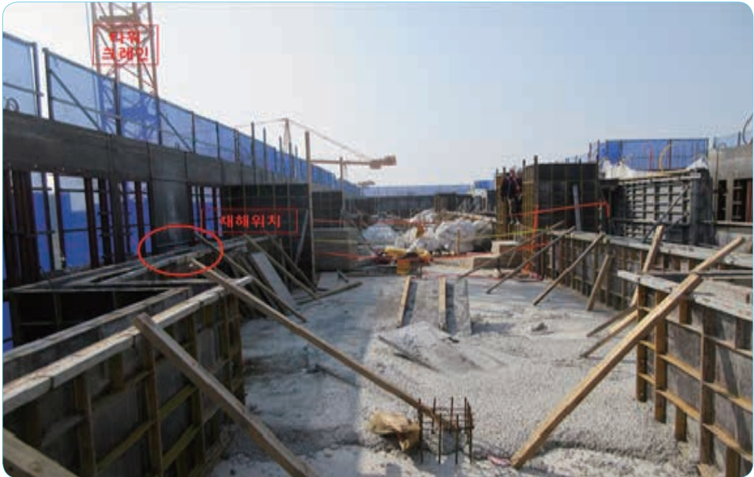
[사진1] 재해발생 현장 전경(옥상층)
