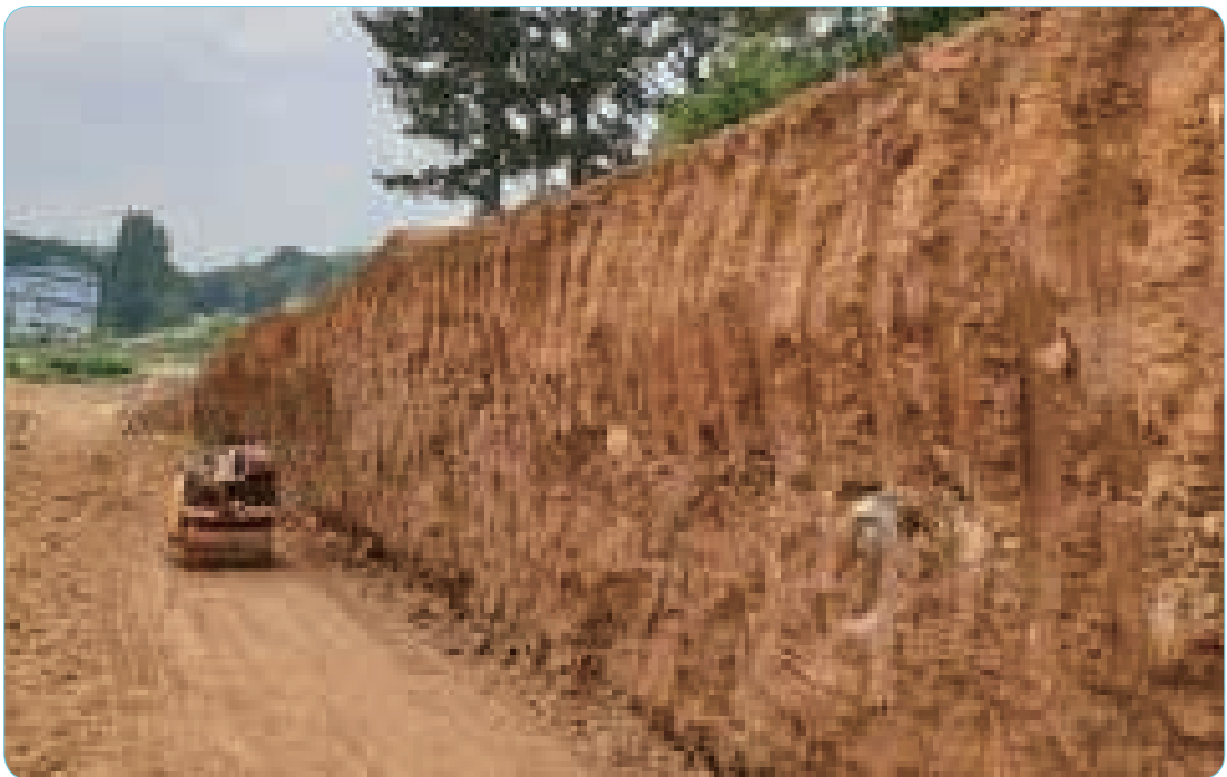
[사진2] 사고구간 인접 굴착면 기울기 상태
