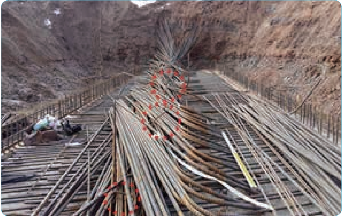
[사진1] 재해발생 현장 전경
