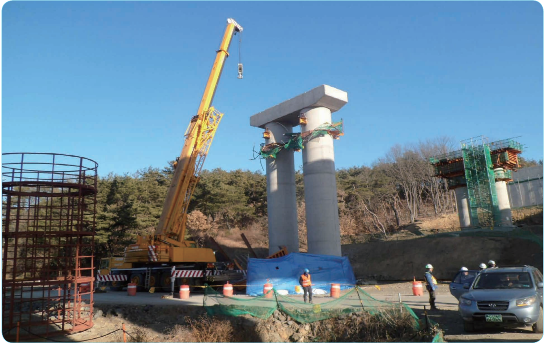
[사진 1] 재해발생 현장 전경
