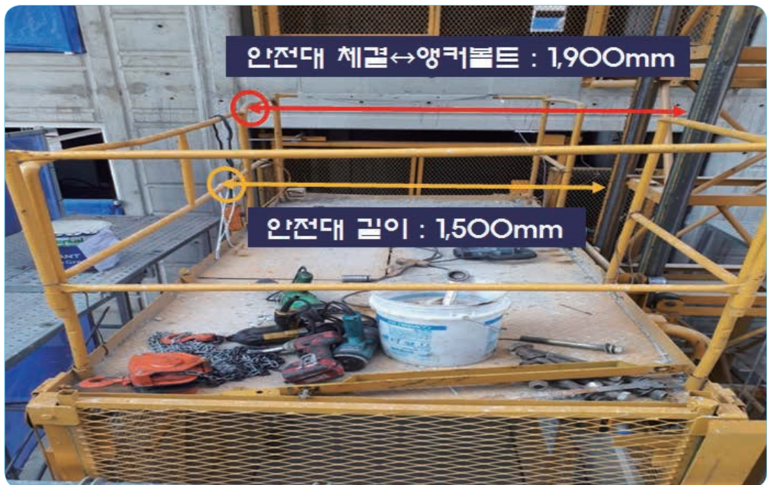
[사진2] 안전대 체결한 위치부터 앵커볼트까지의 길이와 재해자가 착용한 안전대의 길이(400mm차이)
