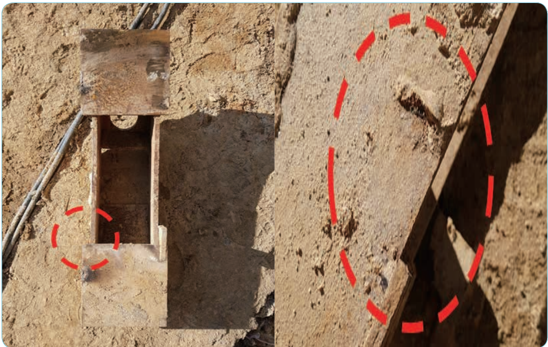
[사진2] 기인물 대좌 (ㄱ자 갈고리형강 탈락 상세)
