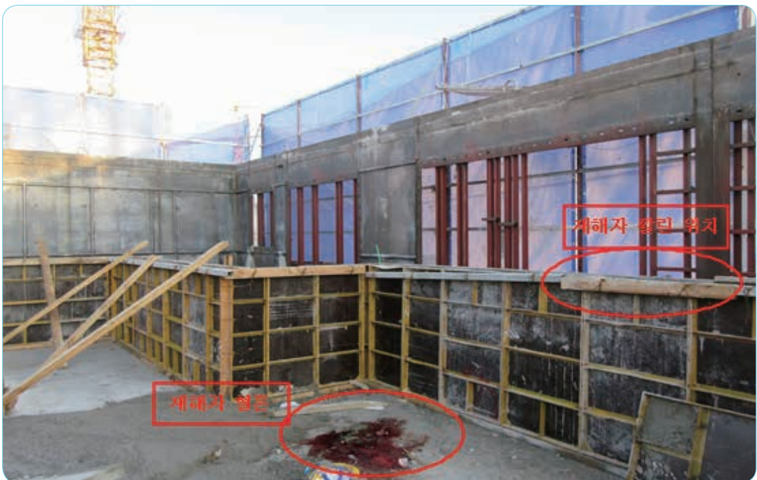
[사진2] 재해발생 작업 장소
