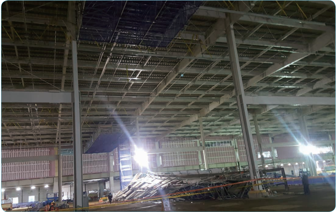
[사진1] 사고현장 전경
