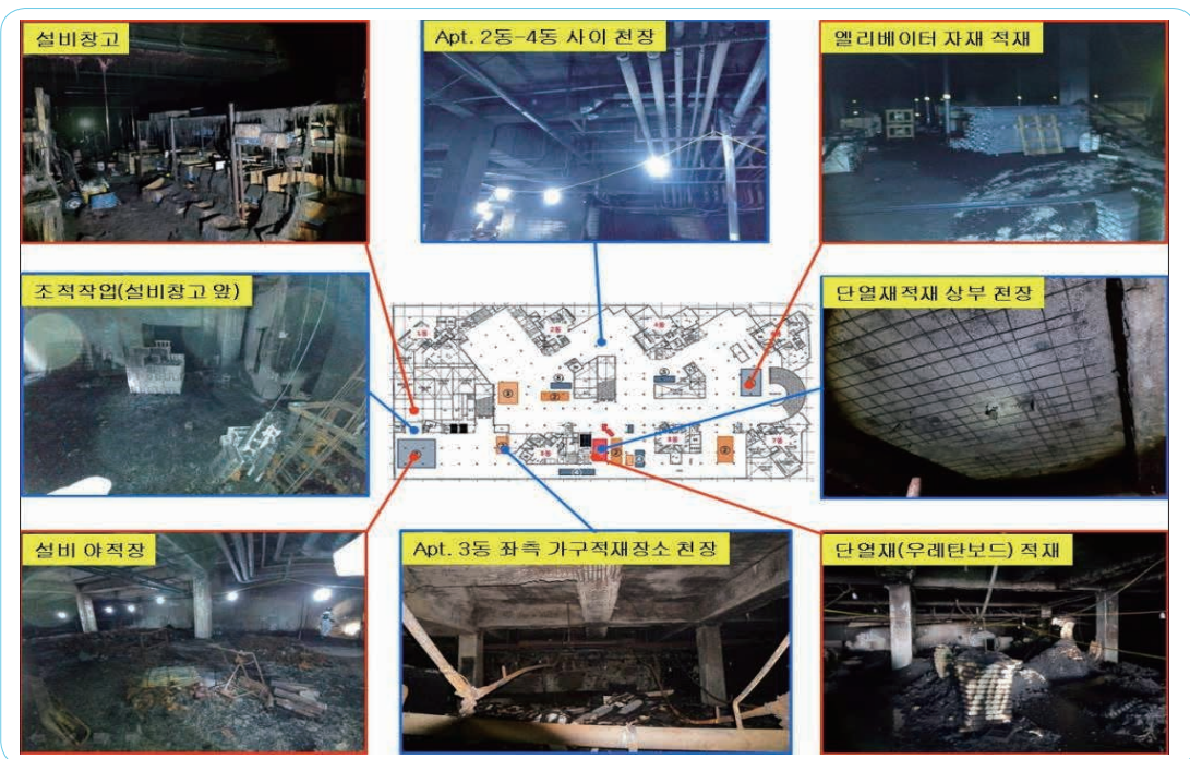
[사진1] 지하1층 구간별 화재에 의한 구조물·자재 등 피해상태
