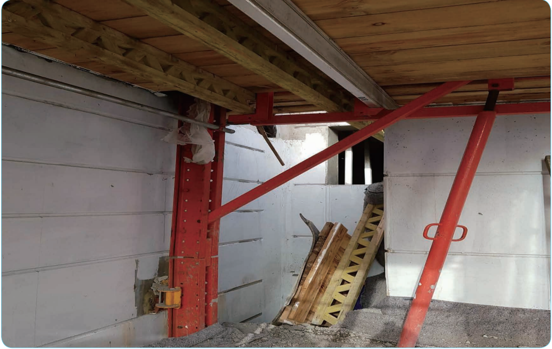
[사진1] 파단된 RCS 작업발판(Level 0 ~ Level-1)
