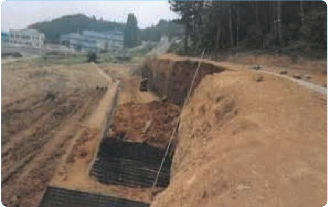
[사진1] 재해발생 현장 전경
