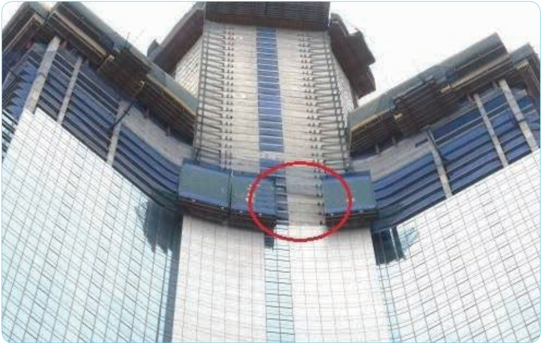
[사진1] 재해발생 현장 전경
