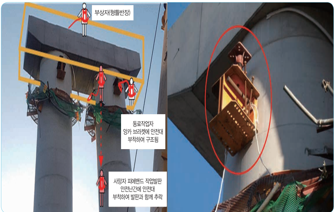
[사진 2] 재해당시 상황(좌) / 전면 정면판 하부 스크류잭 행거볼트 해체상태(우)
