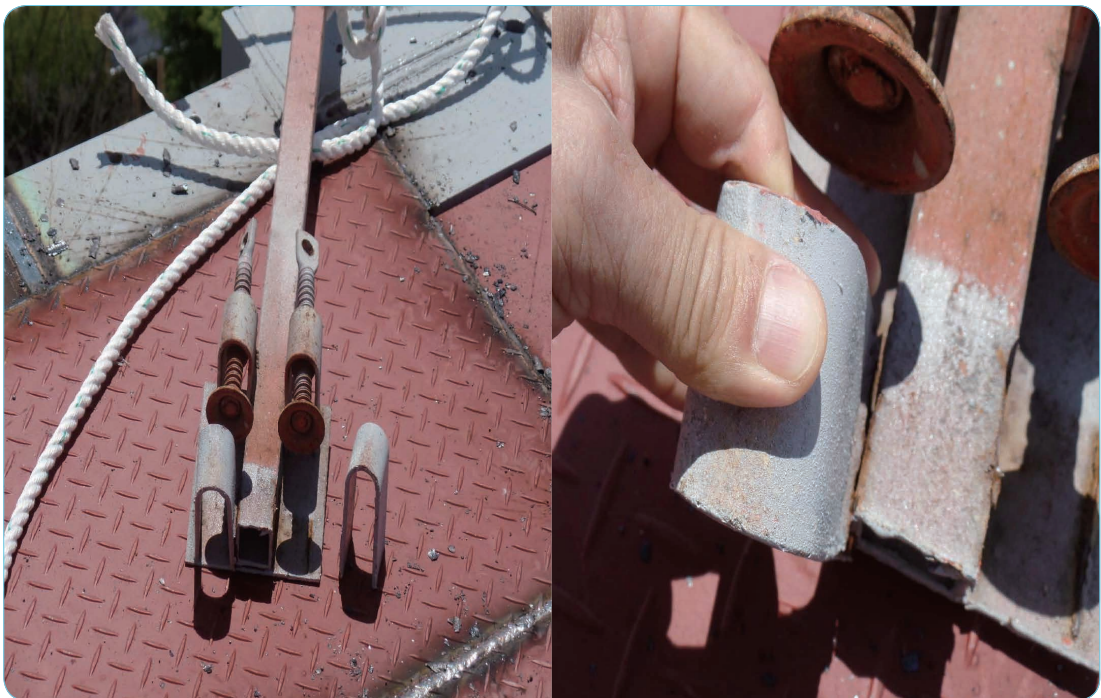
[사진2] 안전난간 기둥재에서 분리된 기둥재 고정 하부 철물(용접부위 부식진행)
