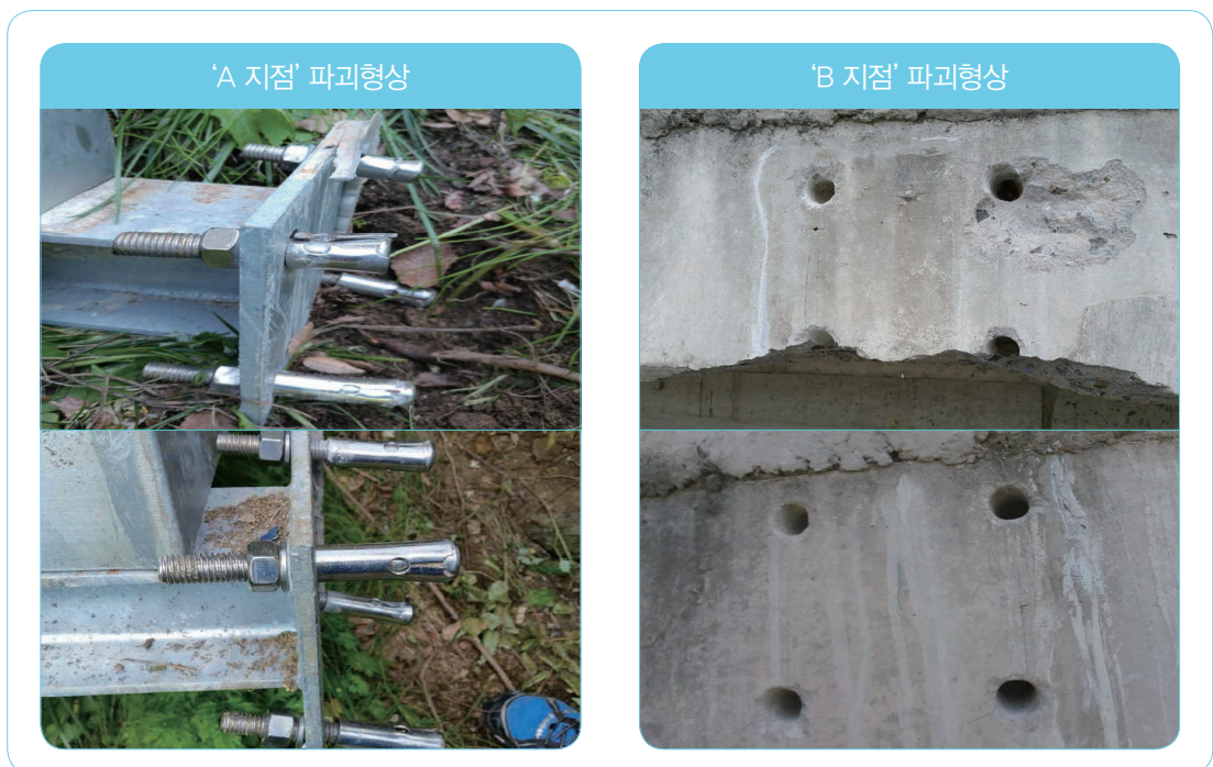
[사진2] 세트앵커볼트 및 콘크리트 파괴형상
