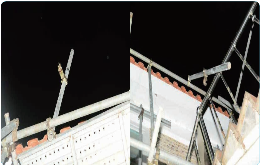
[사진2] 작업구간 왼쪽의 비계기둥(좌) / 재해발생 작업부의 비계기둥(우)
