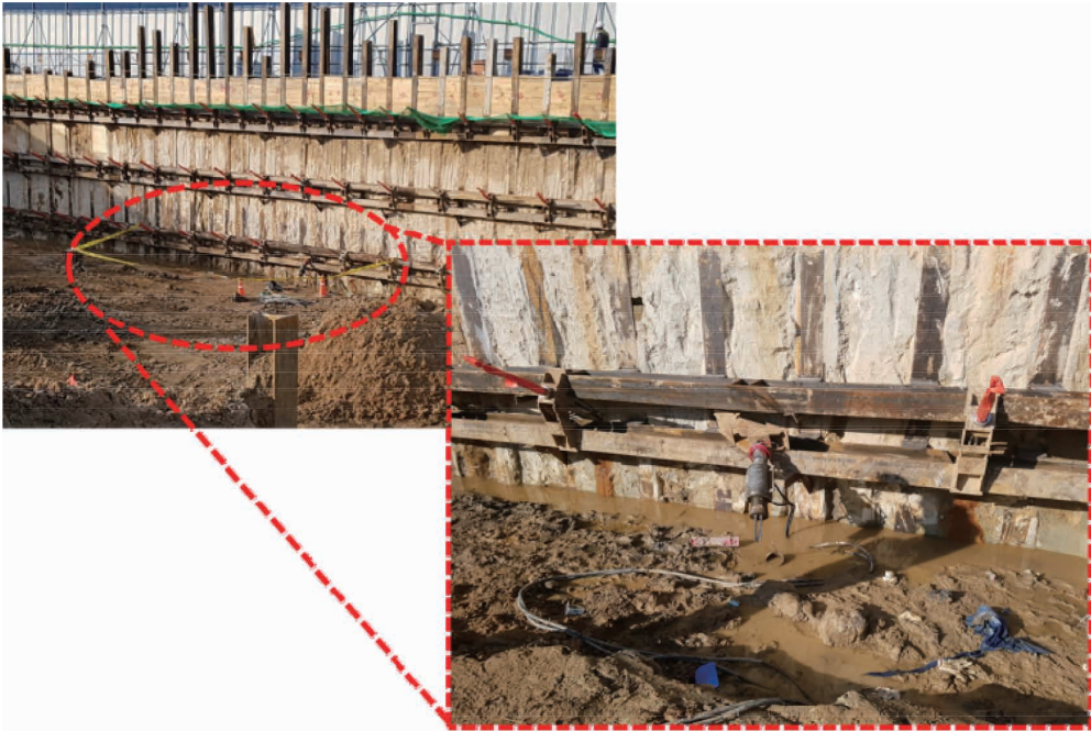
[사진1] 재해발생 현장 전경
